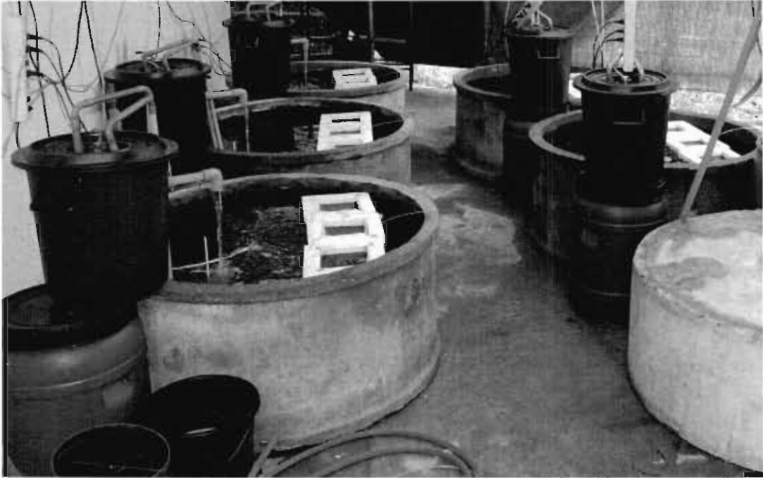
ภาพที่ 5 ปอซีเมนต์กลม ขนาดเส้นผ่านศูนย์กลาง 100 เซนติเมตรพร้อมทั้งติดตั้งระบบบำบัดน้ำ
