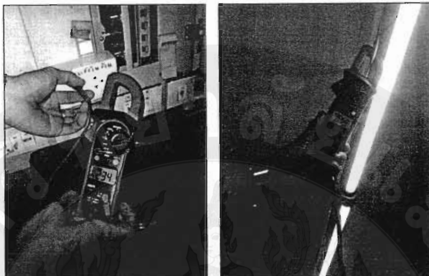
ก) การตรวจวัดค่าปริมาณแรงดันไฟฟ้า ข) การตรวจวัดค่าปริมาณกระแสไฟฟ้า
