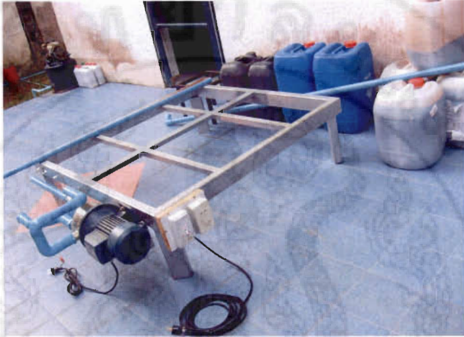
ภาพภาคผนวกที่ 2 ฐานวางถังหมักจุลินทรีย์
