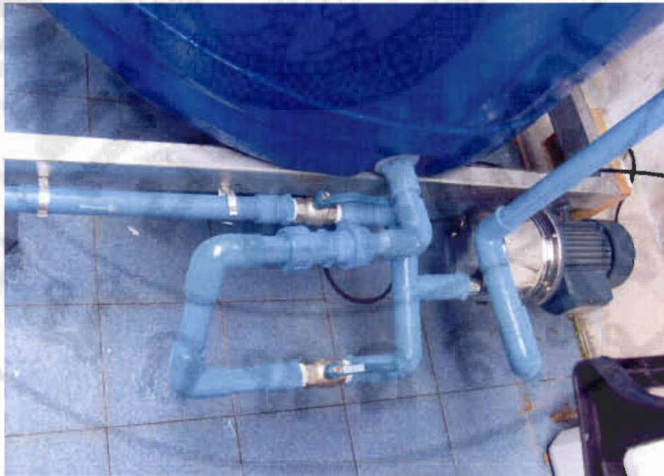
ภาพภาคผนวกที่ 3 ท่อช่องทางรับของเหลวจากภายในและภายนอก
