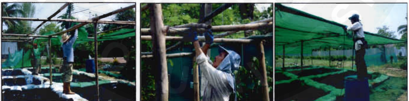
(จ) ซ่อมแซมและติดตั้งไม้ไผ่เพื่อทำเสาและคานหลังคา พร้อมติดตั้งหลังคาที่ทำด้วยตาข่ายพรางแสง 80%
