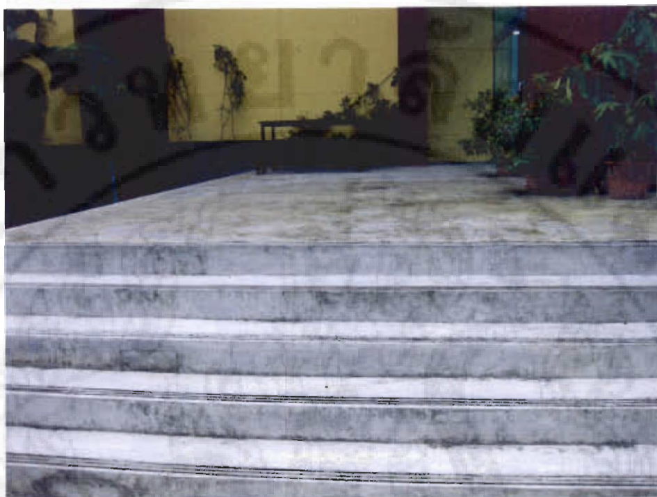
ภาพที่ 40 แสดงลักษณะพื้นคอนกรีต ที่มีค่าการสะสมความร้อนในตัววัสดุสูง ทำให้อุณหภูมิผิวพื้นบริเวณหน้าคณะเทคโนโลยีสารสนเทศและการสื่อสารสูงกว่าอุณหภูมิอากาศ
