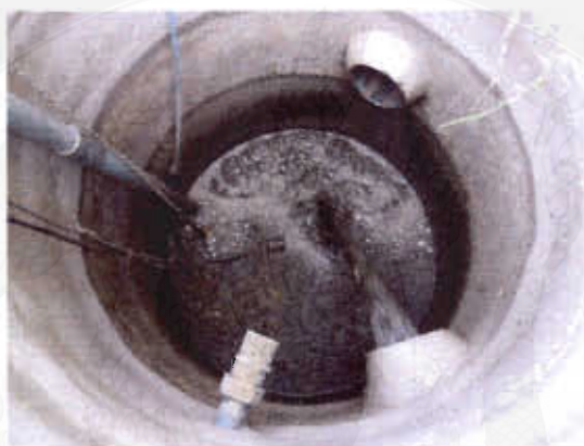
ภาพที่ 19 บ่อพักน้ำเสีย
