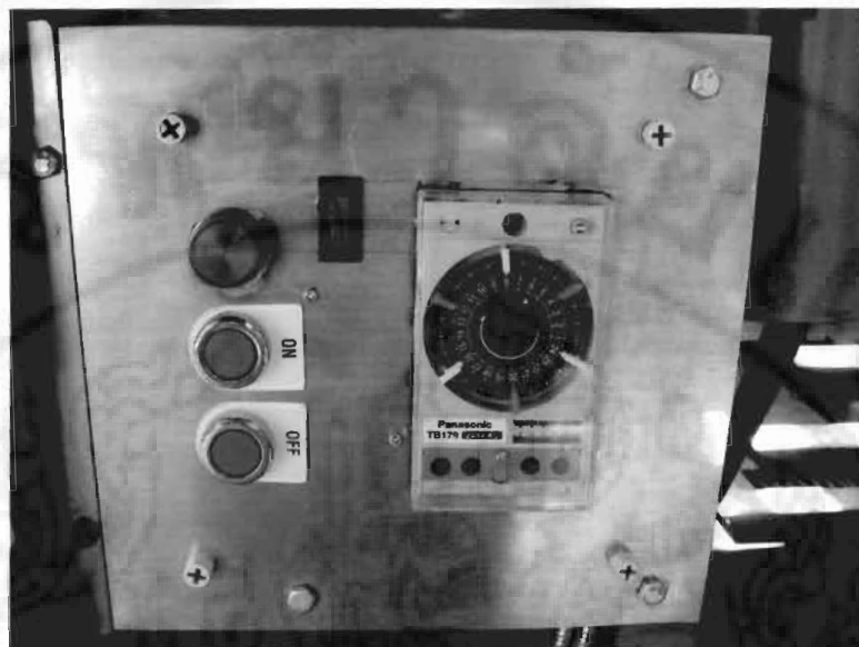
ภาพ 19 แผงควบคุมการทำงานของระบบแยกและย่อยไขมัน
