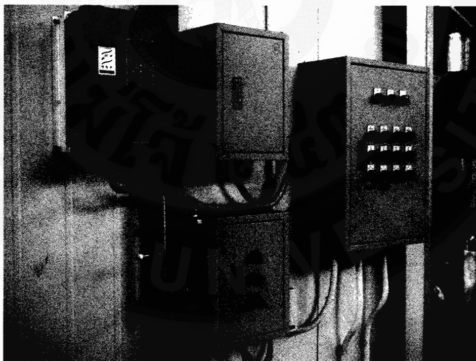
ภาพผนวก 7 ตู้ควบคุมการทำงานของห้องรม \text{SO}_2 ด้วยระบบหมุนเวียนอากาศแบบบังคับในแนวตั้ง
