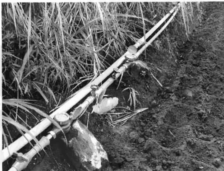
ภาพ 17 การจ่ายน้ำผ่านมาตรวัดน้ำเข้าแปลงเพาะปลูก
