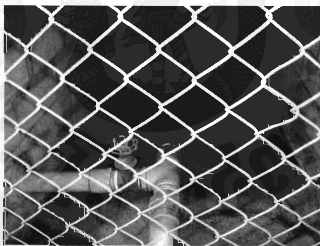
ภาพ 4 เครื่องสูบน้ำบาดาลก่อนแก้ไข
